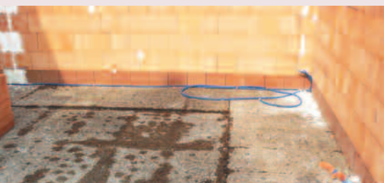
Humidité d'un isolant liège posé avant couverture de la toiture
